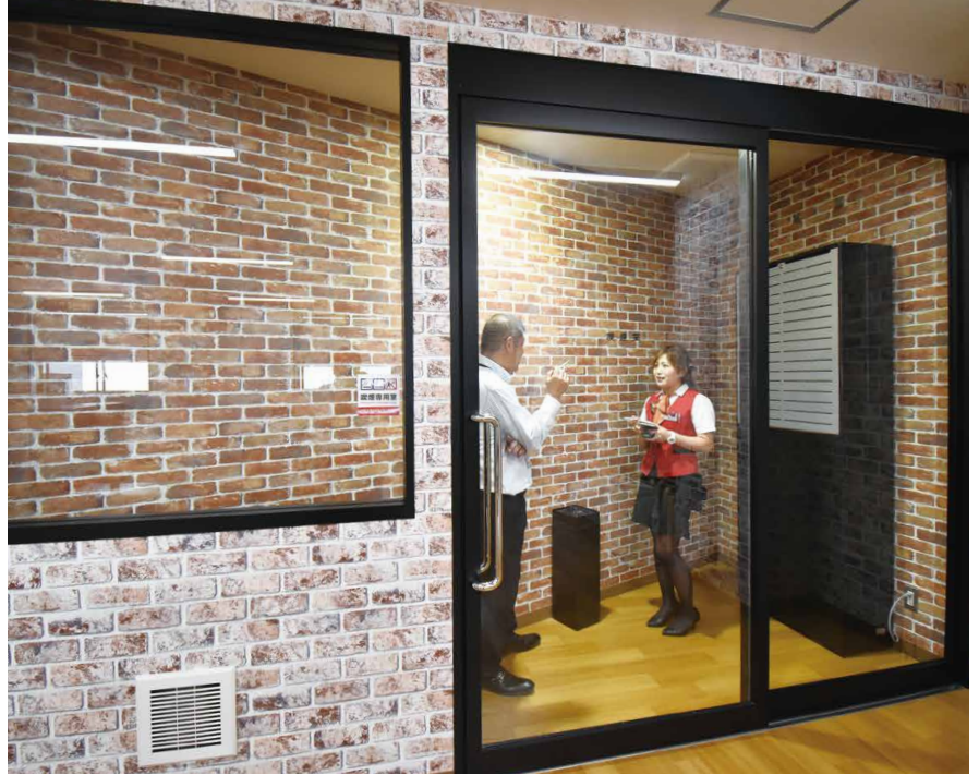
スタッフが利用する喫煙室内に『スモーククリア エアクリーンW』を導入。ウイルス・煙をW除去する高性能フィルター搭載で、喫煙室内の空気環境を改善する。
